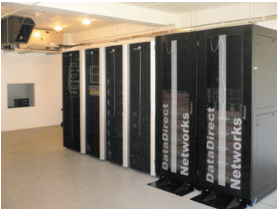
Стойки с серверами, системой хранения и другими устройствами
